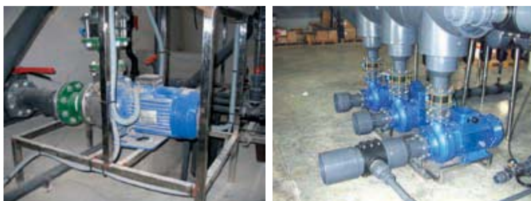
Fotografía 1.2: Bombas de presión en paralelo en una instalación de riego.
