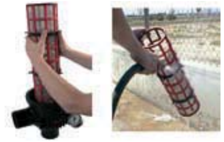
Fotografía 3.7: Detalle de limpieza de filtros de malla. (Foto Sistema AZUD, SA).
