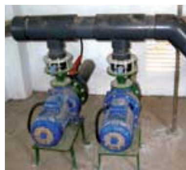
Fotografía 3.2: Equipo de bombeo.
