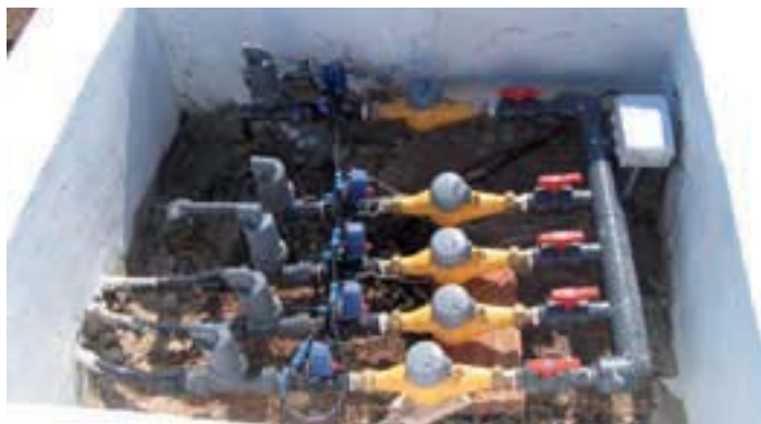
Fotografía 1.11: Arqueta de control para 5 unidades de riego. Consta de ventosa, electroválvula, contador y llave de bola para cada sector.
